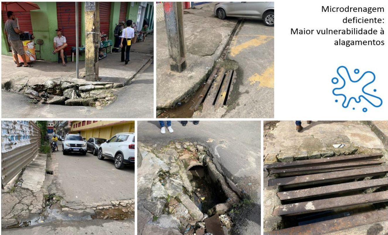
Figura 10 – Elementos da microdrenagem - situação da microdrenagem.
